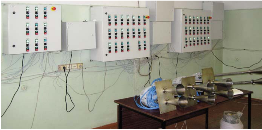
Рис. 3. Шкафы управления на этапе проведения испытаний
